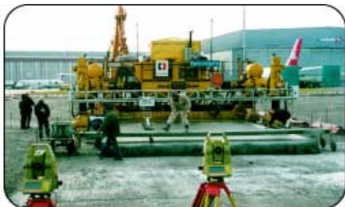
Две полных станции, оборудованные моделями и радио передают координаты в Центр Команд, установленному на GHP-2800
